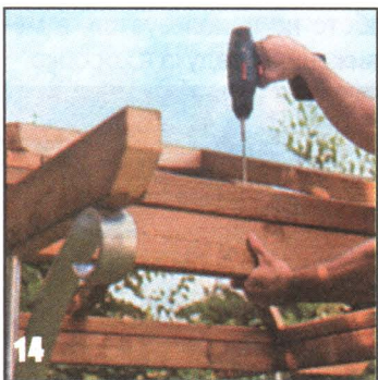
Установив стропильную конструкцию, её крепят шурупами, ввёртываемыми сквозь бруски обвязки в несущую раму.
